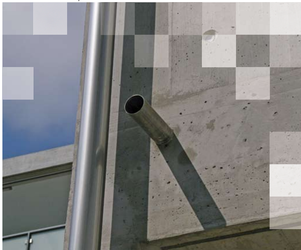
Wohnhaus St. Gallen: Balkonspeier
